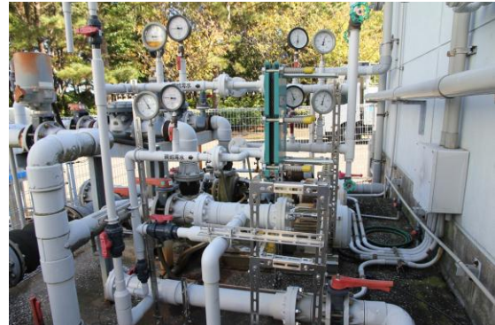
海水ヒートポンプの導入
